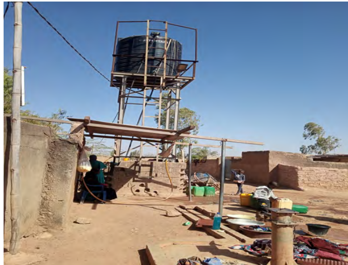
Photo 1 : Poste d'eau autonome à Goundrin (photographie des auteurs)
